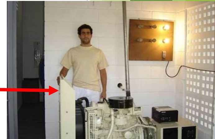
Grupo gerador e Painel de teste
